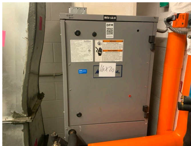
22 - FAN COIL UNIT
